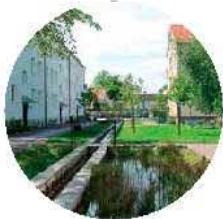
Traitement des eaux grises sur site, Malmö Augustenborg, Suède
