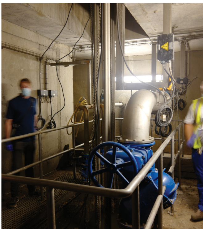
het ondergrondse pompstation
