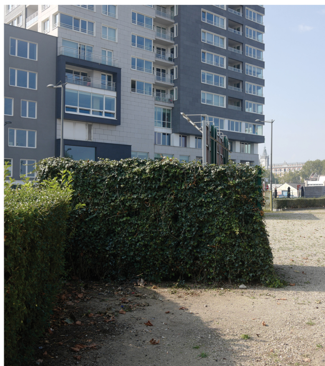
het bovengrondse elektrisch substation
